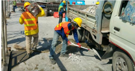
จัดเก็บเศษวัสดุก่อสร้างในพื้นที่ก่อสร้าง
