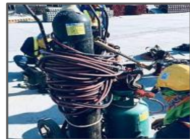
ตรวจถังลมและถังแก๊ส
