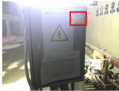
ตรวจสอบสภาพตู้ไฟประจำเดือน
