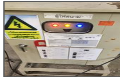
ตรวจตู้ไฟฟ้า
