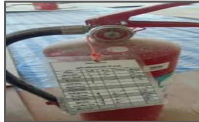
การตรวจสอบถังดับเพลิง
