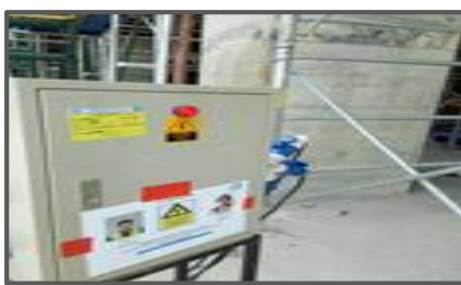
ตรวจเครื่องมือและอุปกรณ์ไฟฟ้า
