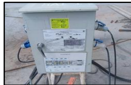
ตรวจตู้ไฟฟ้า
