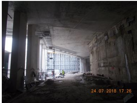
งานรื้อย้าย Raking ระหว่าง South Tunnel & Sat-1
