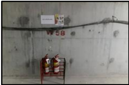
ตรวจเช็คถังดับเพลิง
