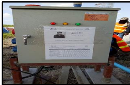
ตรวจตู้ไฟฟ้า
