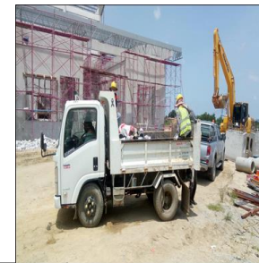
จัดเก็บเศษวัสดุก่อสร้างออก จากพื้นที่ก่อสร้าง
