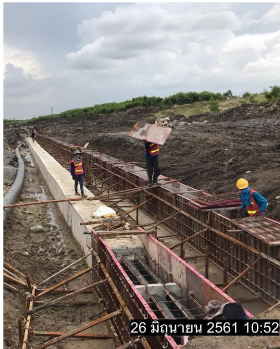
MH14-15 (24kV) ช่วงเข้าบ่อ
