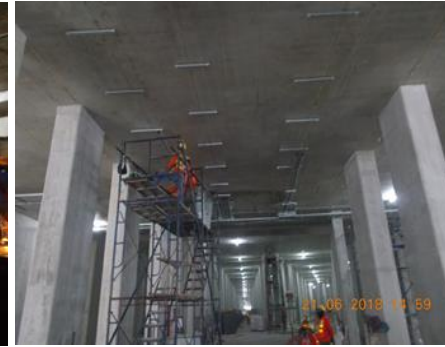
งานติดตั้งท่อ Conduit ระบบไฟฟ้า New Tunnel
