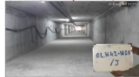
SCS และ ITD ยังไม่อนุญาตให้เข้าพื้นที่
