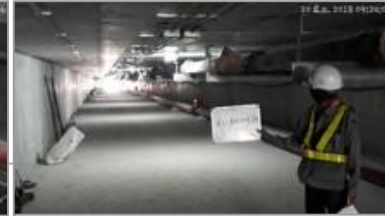
เข้าติดตั้งท่องานระบบได้เมื่อวันที่ 18/06/61
