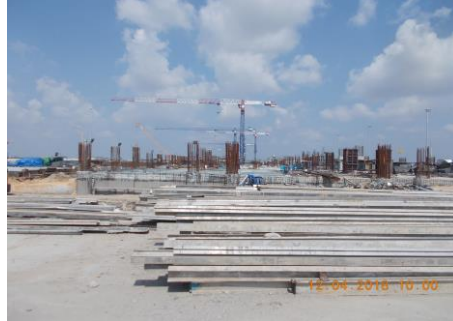
งาน Water Tank
