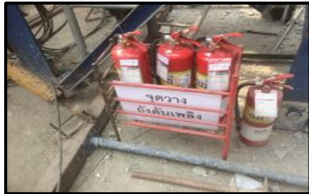
ตรวจเช็คถังดับเพลิง
