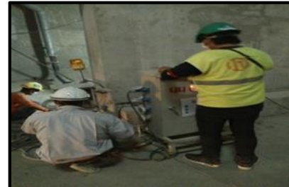
ตรวจตู้ไฟฟ้า
