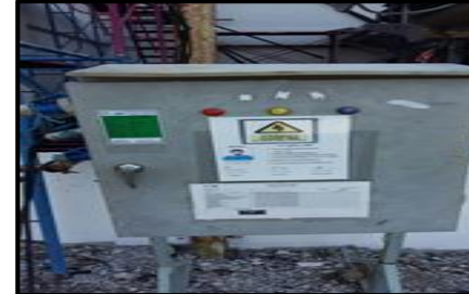
ตรวจตู้ไฟฟ้า
