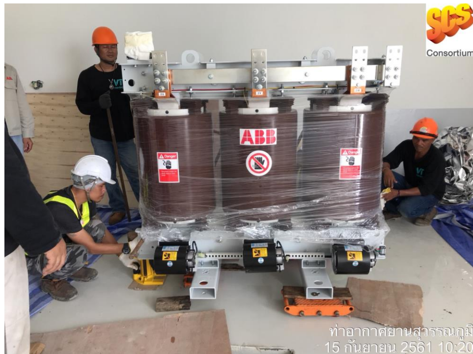
หม้อแปลง 1000 kVA เข้าพื้นที่หน้างาน
