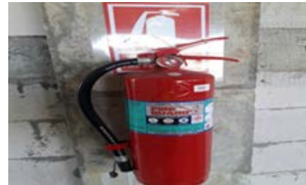
ตรวจเช็คถังดับเพลิง
