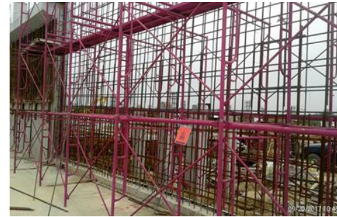
หลังแก้ไข ติด Tag ไม่อนุญาตให้ใช้นั้งร้าน
