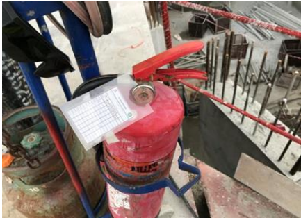
ตรวจถังดับเพลิง
