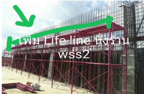
ก่อนแก้ไข นั้งร้านไม่สมบูรณ์
